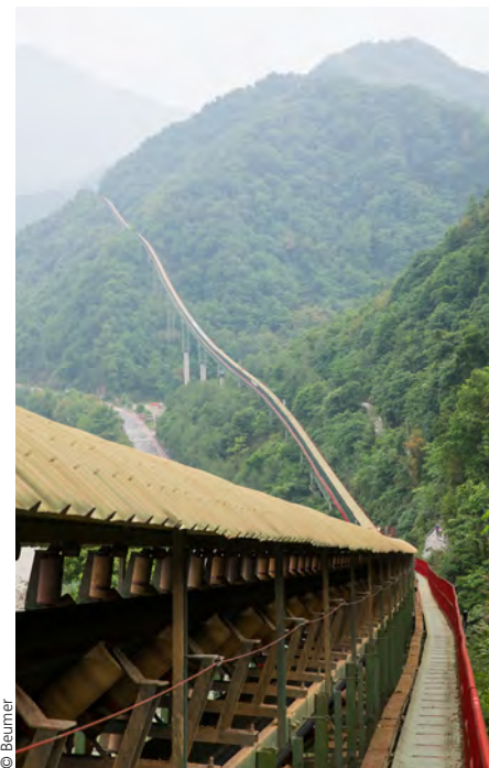
→ Transporteur à courroie en auge installé sur un terrain accidenté.
